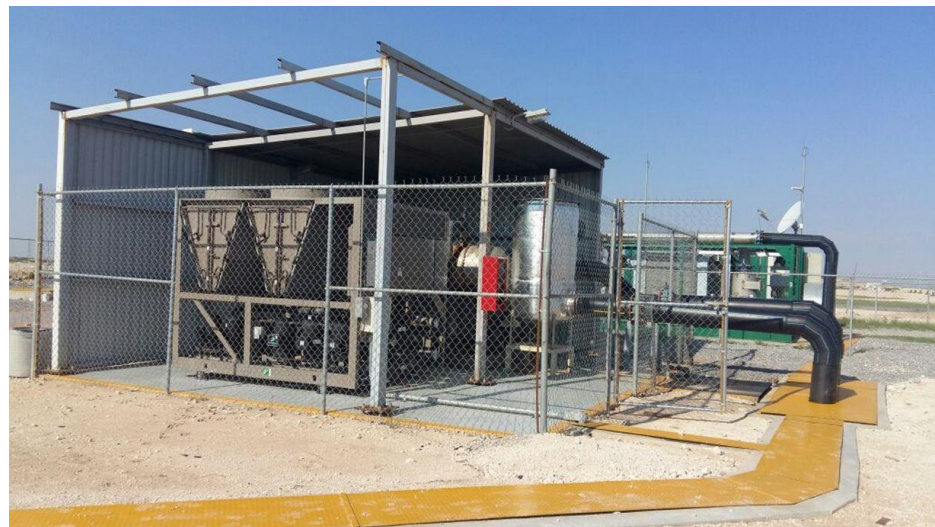
Cuarto de máquinas para la generación de energía eléctrica
