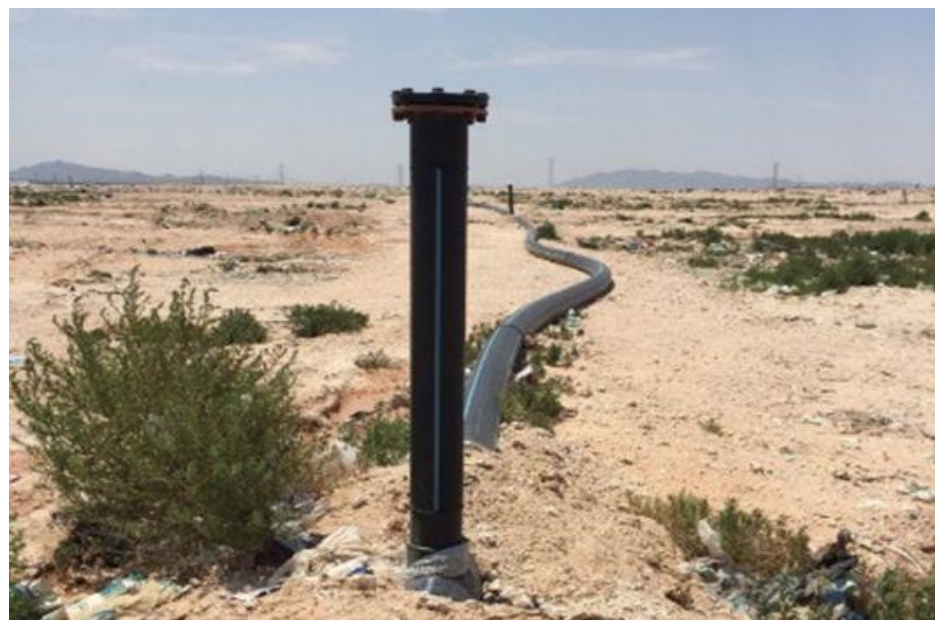
Red subterránea de tubería para la captura y extracción del biogás
