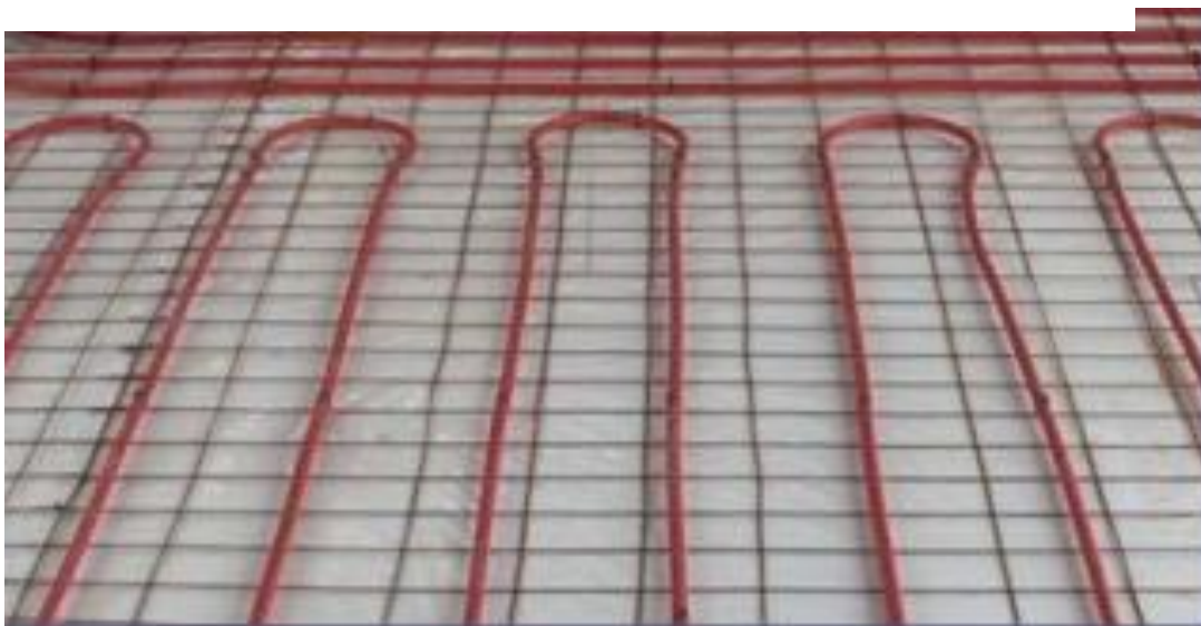
Figura 3. Paneles aisladores instalados en el Sistema S.F
