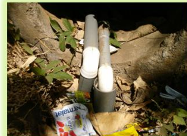
Tuberías de agua potable en Comarca Miravalle
