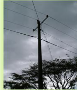
Poste de energía eléctrica en la comunidad Miravalle
