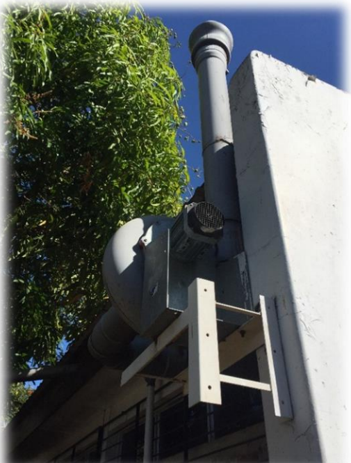
Ilustración 16. Purgación del ventilador centrifugo.
