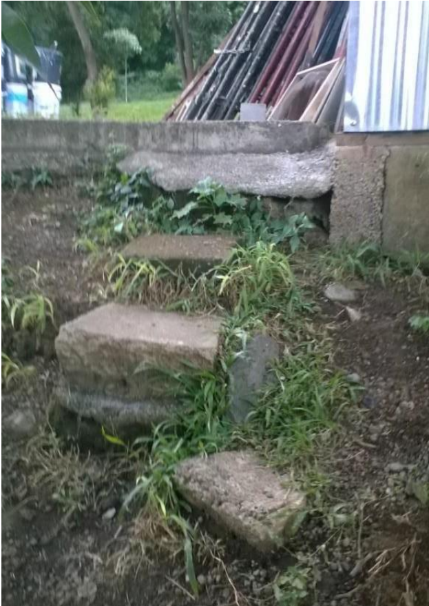
Ilustración 12. Carencia de escaleras en Pabellón 23.
