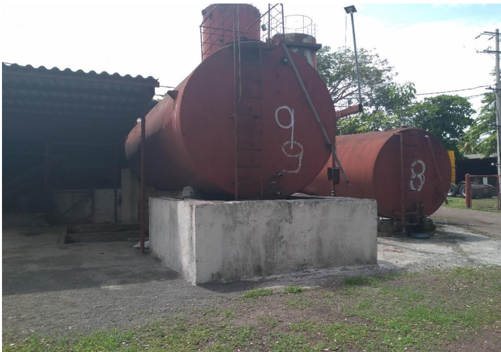
Ilustración 17 Tanques de grasa final.
