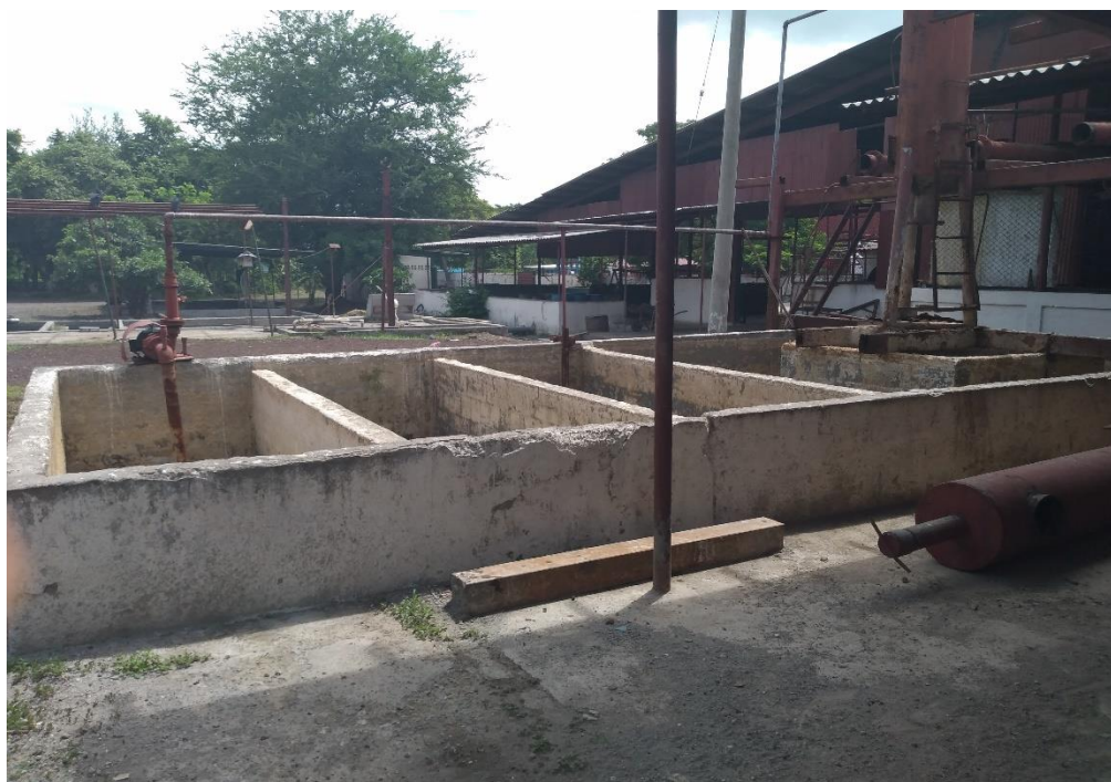
Ilustración 20 Pilas de tratamiento de aguas.
