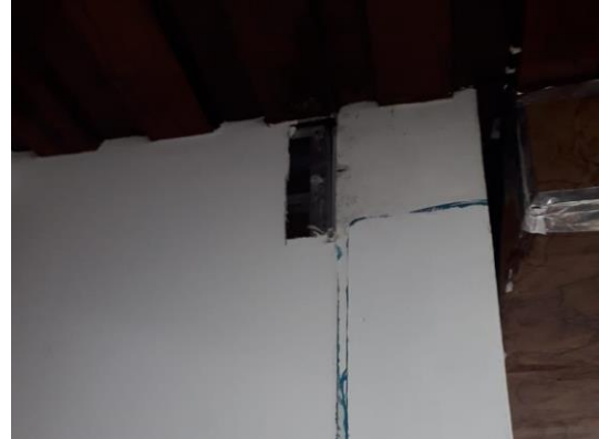
Figura 28. Aberturas sin acabado
