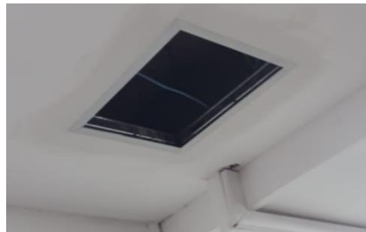
Figura 18. Ruptura sin acabado Fuente: Propia
