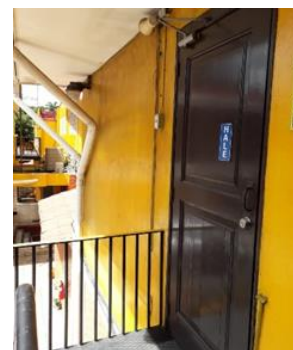
Figura 7. Puerta sin señalización.
