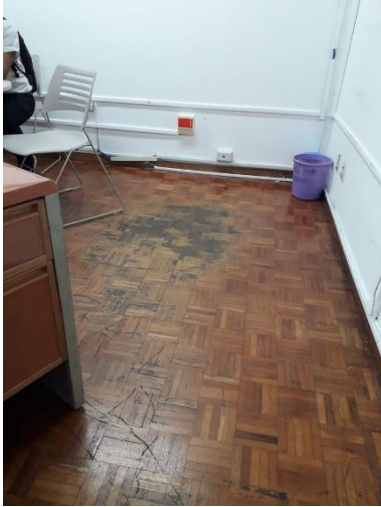
Figura 49. Piso en mal estado Fuente: Propia
