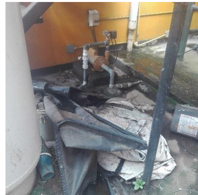
Figura 46. Materiales mal ubicados
