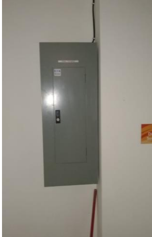
Figura 31. Panel sin Señalización Fuente: Propia
