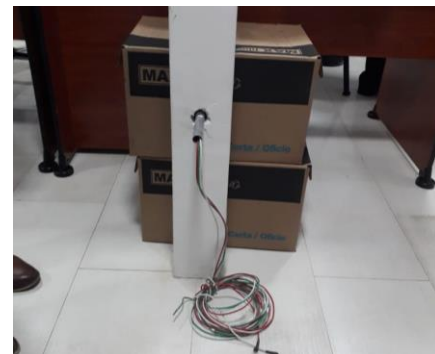
Figura 36. Cables sueltos. Fuente: Propia
