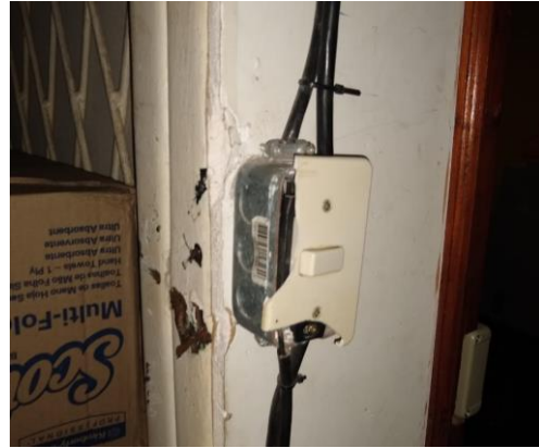
Figura 26. Conexiones en mal estado.
