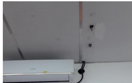
Figura 16. Cielo sin mantenimiento Fuente: Propia
