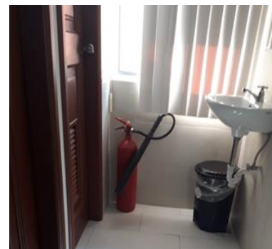
Figura 9. Mala ubicación de extintores.
