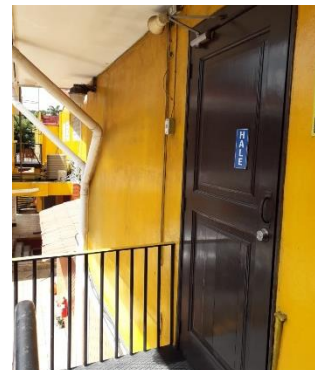
Figura 48. Puerta sin señalización
