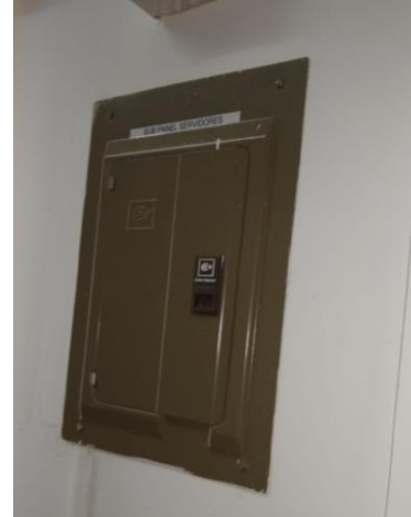
Figura 32. Panel sin Señalización Fuente: Propia
