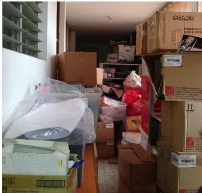
Figura 21. Pasillo en uso como bodega Fuente: Propia
