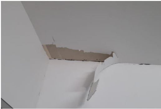
Figura 13. Techo sin mantenimiento Fuente: Propia
