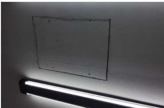
Figura 17. Ruptura sin acabado Fuente: Propia
