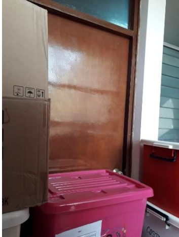
Figura 43. Obstrucción de puertas
