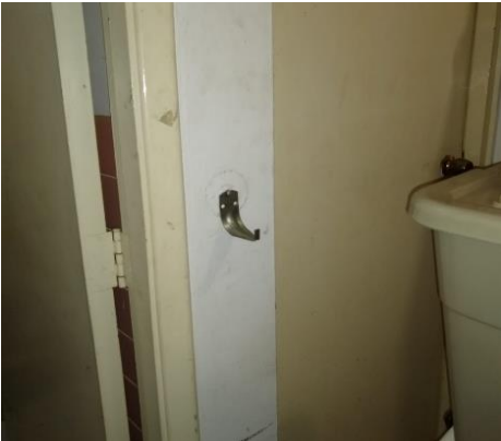
Figura 27. Equipos extintores no ubicados
