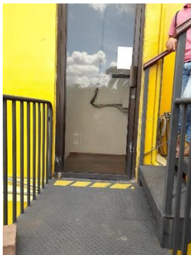
Figura 47. Puerta sin señalización
