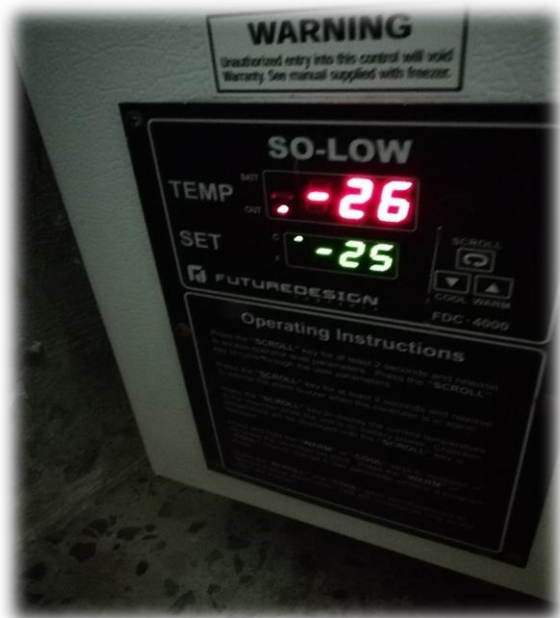
Figura No. 57. Medidor de temperatura del almacenamiento de los residuos patológicos.
