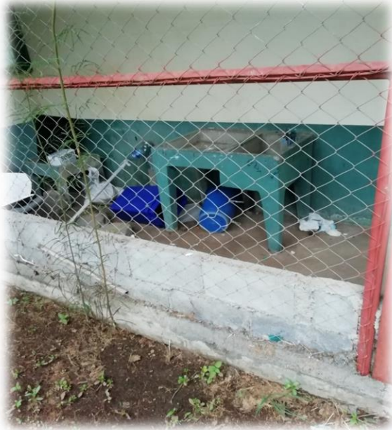
Figura No. 32. Área de almacenamiento temporal Contiguo a Hemodiálisis sin depósitos adecuados.
